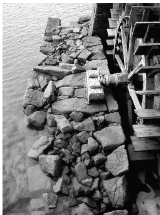
Vous pouvez constater que la remise en état de cet ouvrage est loin d'être superflu...
