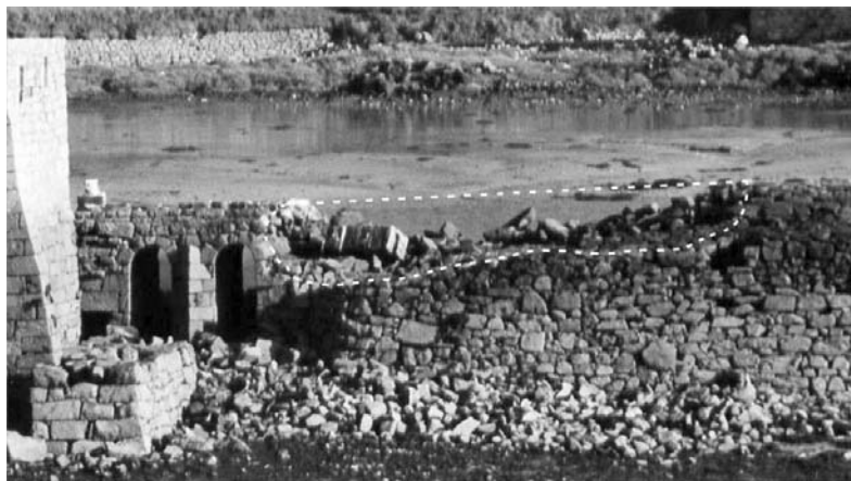
Sur cette photo datant de 1994 (10 ans seulement !) on distingue la brèche (soulignée par des tirets) de la digue ou plutôt du batardeau... colmatée un an plus tard.
